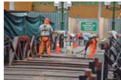
Trabajos de reforzamiento del Puente de Los Suspiros incluye nueva iluminación Led.
